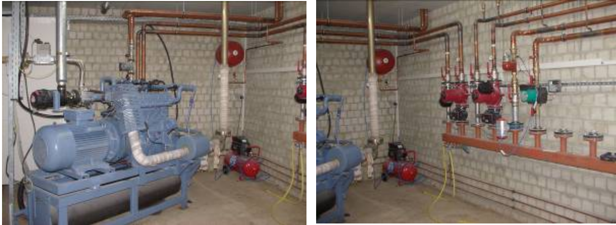
Abbildung 4: BHKW- und Heizungsraum
