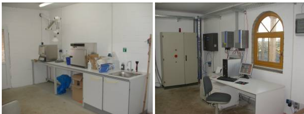
Abbildung 6: Labor und Technikraum
